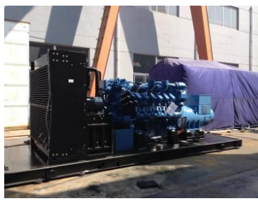
西藏机场 1200KW MTU静音发电机
